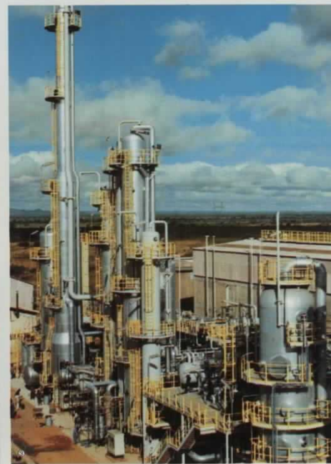
② Anlage zur Aufbereitung von Rohgas aus der Kohlevergasung zu Synthesegas für die Ammoniak- und Methanolsynthese
